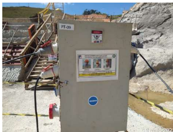
Foto 126 – Painel elétrico inspecionado na frente de serviço. (Data:13/05/2022)
