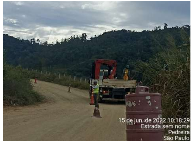
Foto 192 – Sinalização vertical implantada em via interna. (Data:15/06/2022)
