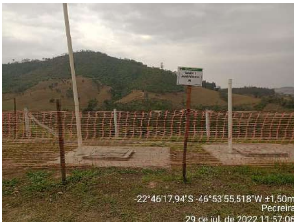
Foto 237 – Biodigestor 01 no canteiro industrial. (Data:29/07/2022)
