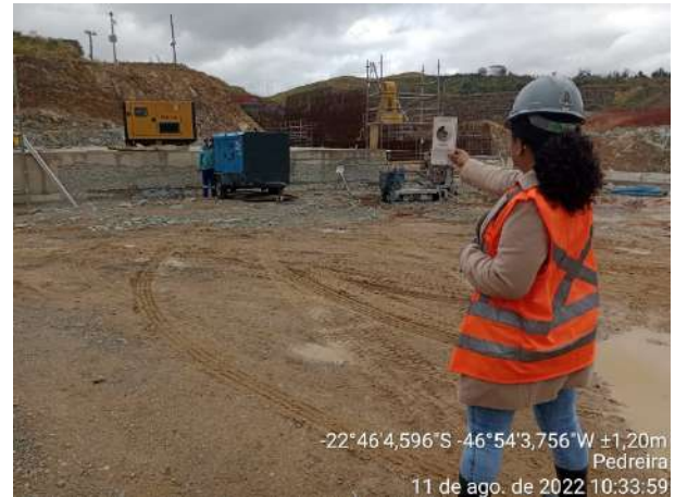
Foto 262 – Medição de fumaça preta em gerador na frente de serviço. (Data:11/08/2022)
