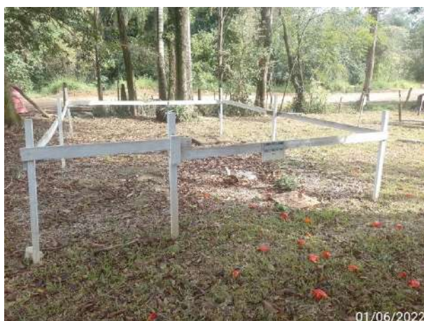
Foto 231 – Biodigestor 01 no canteiro administrativo. (Data:01/06/2022)
