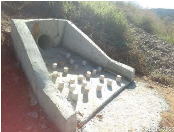
Foto 207 – Adequação da saída do sistema de drenagem, com dissipador de energia hídrica, na área de plantio 9.17. (Data:23/06/2022)
