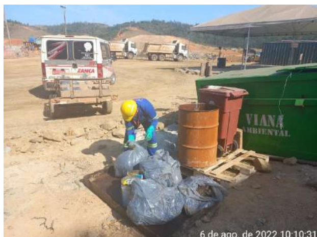
Foto 45 – Colaborador realizando o recolhimento dos resíduos Perigosos da frente de serviço. (Data:06/08/2022)
