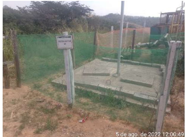
Foto 242 – Biodigestor 01 no canteiro industrial. (Data:05/08/2022)
