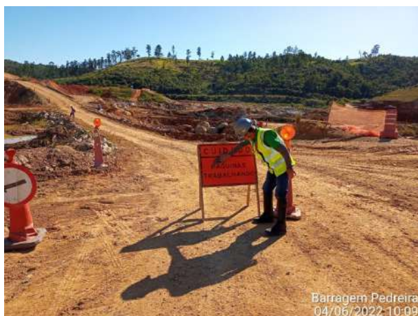
Foto 189 – Sinalização vertical implantada em via interna. (Data:04/06/2022)
