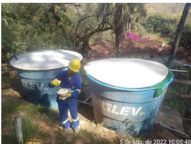
Foto 113 – Adequação de dosagem de cloro na caixa de água disposta na frente de serviço. (Data:05/08/2022)
