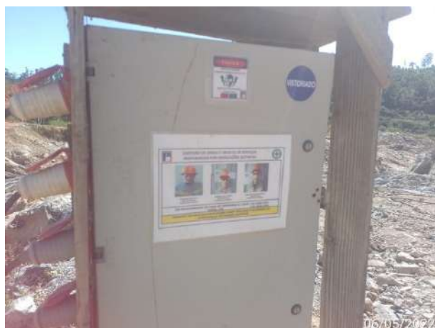
Foto 125 – Painel elétrico inspecionado na frente de serviço. (Data:06/05/2022)
