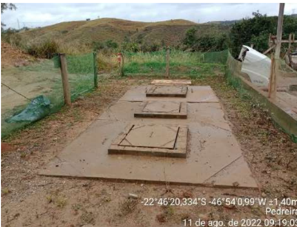
Foto 223 – Sistema de Separação de Água de Óleo – S.A.O, localizado na Oficina Mecânica. (Data:11/08/2022)
