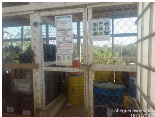
Foto 40 – Vista geral da baía de armazenamento de Produtos Perigosos na Oficina Mecânica. (Data:18/07/2022)
