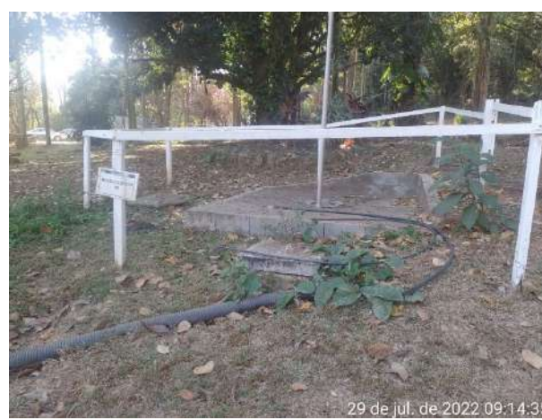
Foto 246 – Biodigestor 02 no canteiro administrativo. (Data:29/07/2022)
