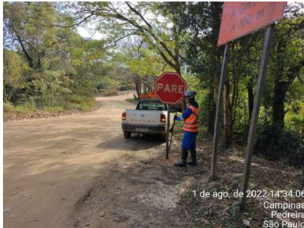
Foto 197 – Sinalização vertical implantada em via interna. (Data:01/08/2022)
