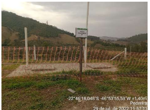
Foto 238 – Biodigestor 02 no canteiro industrial (Data:29/07/2022)
