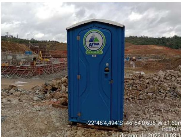
Foto 243 – Vista do sanitário químico na frente de serviço (Data:11/08/2022)
