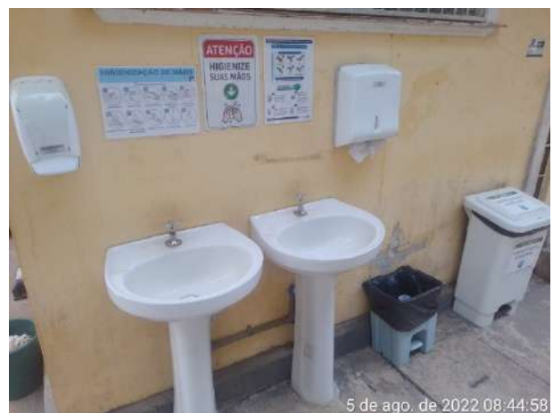
Foto 152 – Lavatório provido de sabão e álcool em gel na entrada do canteiro administrativo. (Data:05/08/2022).
