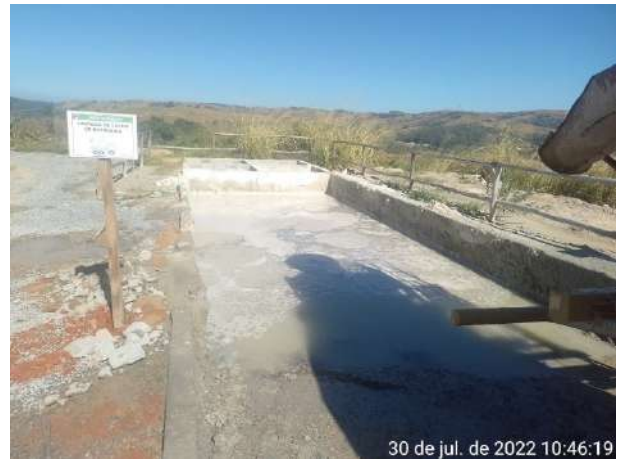
Foto 222 – Sistema de Tratamento de Efluentes para lavagem de bicas de betoneira no canteiro industrial. (Data:30/07/2022)
