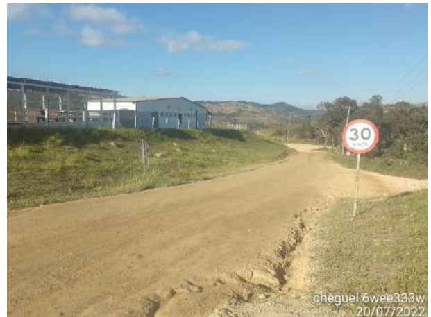
Foto 194 – Sinalização vertical implantada em via interna. (Data:20/07/2022)
