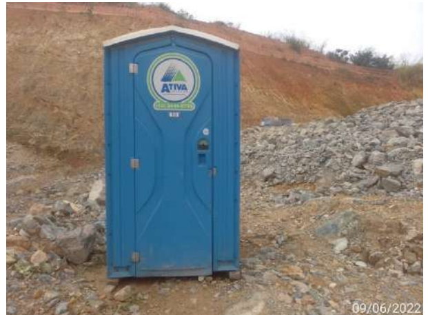
Foto 234 – Vista do banheiro químico disposto na frente de serviço. (Data:09/06/2022).
