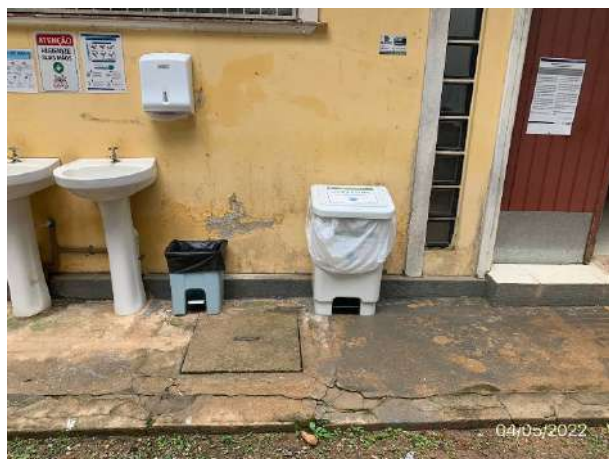
Foto 145 – Pias para higienização das mãos no canteiro administrativo. (Data:04/05/2022).
