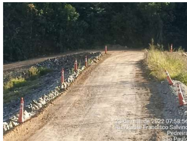
Foto 188 – Sinalização vertical implantada em via interna. (Data:23/05/2022)
