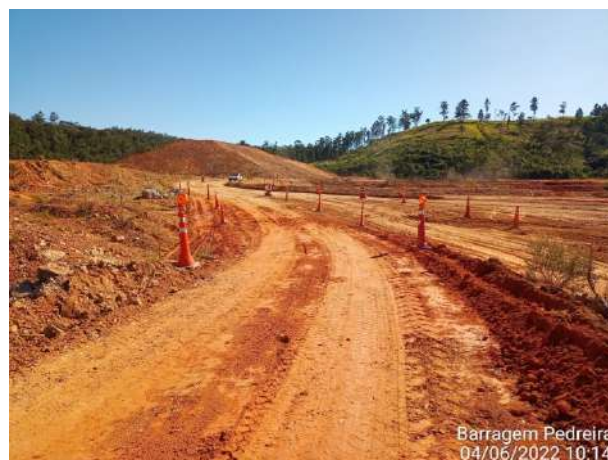
Foto 190 – Sinalização vertical implantada em via interna. (Data:04/06/2022)
