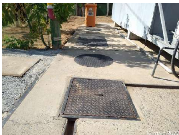
Foto 217 – Caixas de direcionamento e contenção no posto de abastecimento. (Data:13/05/2022)
