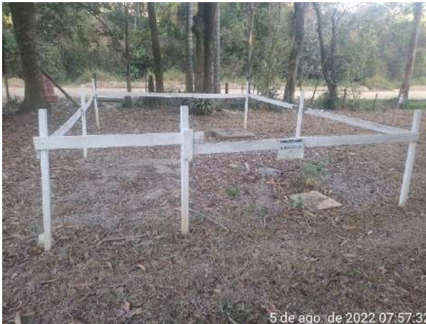
Foto 241 – Biodigestor 01 no canteiro administrativo. (Data:05/08/2022)
