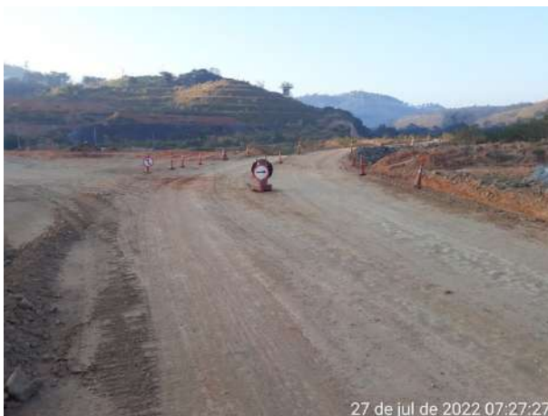
Foto 195 – Sinalização vertical implantada em via interna. (Data:27/07/2022)
