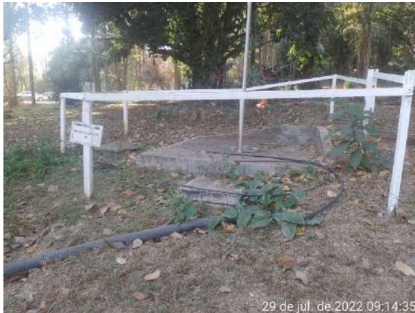
Foto 239 – Biodigestor 02 no canteiro administrativo. (Data:29/07/2022)
