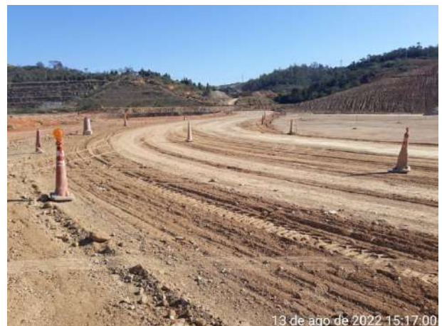
Foto 200 – Sinalização vertical implantada em via interna. (Data:13/08/2022)
