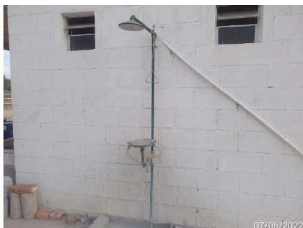
Foto 37 – Vista do chuveiro de emergência disposto na frente de serviço. (Data:07/06/2022)
