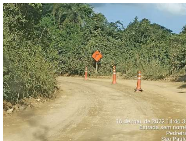
Foto 186 – Sinalização vertical implantada em via interna. (Data:16/05/2022)
