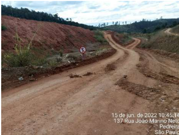
Foto 191 – Sinalização vertical implantada em via interna. (Data:15/06/2022)
