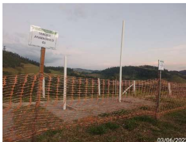
Foto 232 – Biodigestor 01 no canteiro industrial. (Data:03/06/2022)
