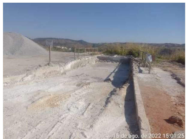
Foto 224 – Sistema de Tratamento de Efluentes para lavagem de bicas de betoneira no canteiro industrial. (Data:15/08/2022)
