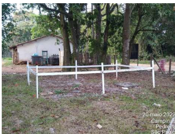
Foto 229 – Biodigestor 01 no canteiro administrativo. (Data:20/05/2022)
