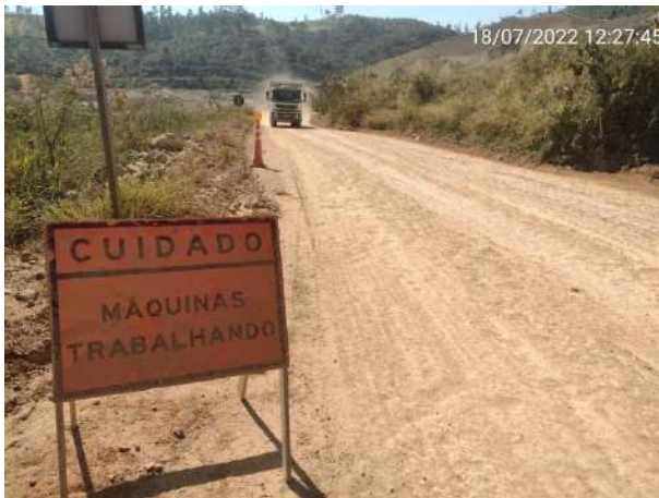
Foto 193 – Sinalização vertical implantada em via interna. (Data:18/07/2022)
