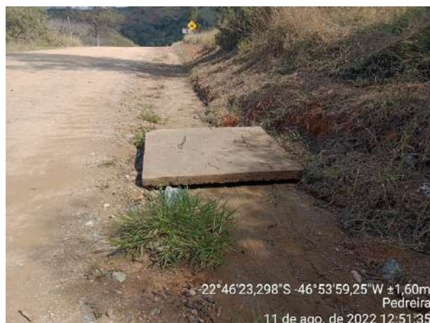
Foto 211 – Sistema de drenagem. (Data:11/08/2022)
