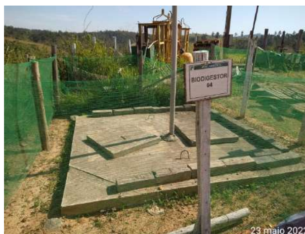
Foto 230 – Biodigestor 04 no canteiro industrial. (Data:23/05/2022)
