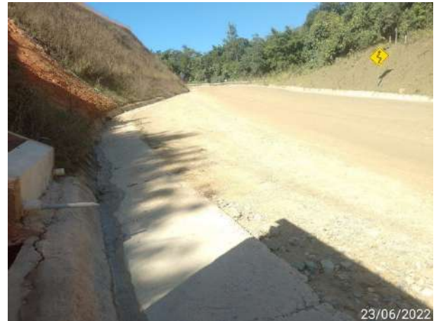
Foto 206 – Sistemas de drenagens implantadas nas laterais da estrada MD03 para disciplinamento das águas pluviais. (Data:23/06/2022)
