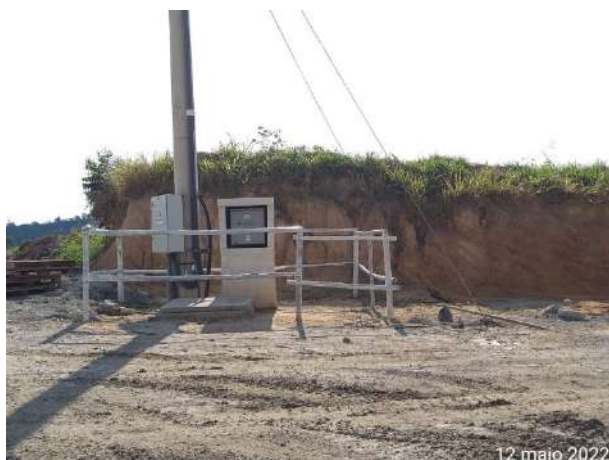
Foto 117 – Reutilização de madeira na fabricação de isolamento em painel elétrico na frente de serviço. (Data:12/05/2022)
